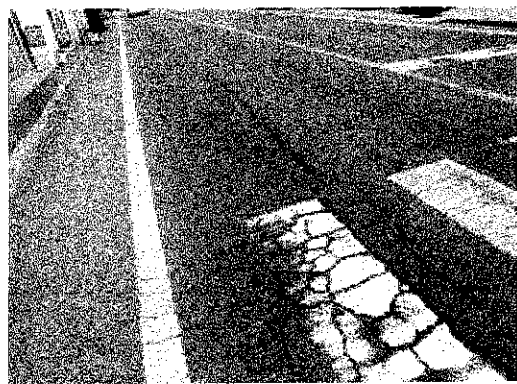
総合支所前のひび割れた幹線道路
